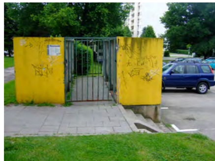
Gestaltung Müllhäuschen schlechte Erreichbarkeit für Kinder und ältere Menschen Größe nicht ausreichend für die Unterbringung notwendiger Wertstofftonnen (Papier...)
